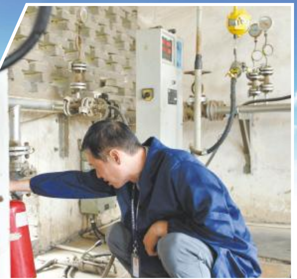
执法人员在液化气企业检查消防设备
