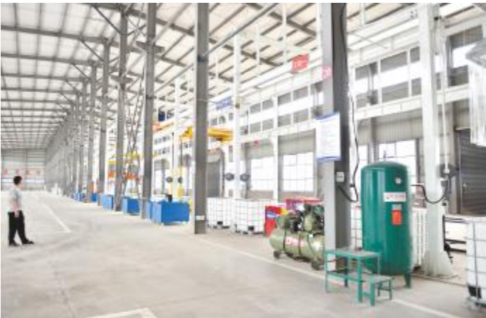
自动化厂房设备安装完毕待生产
