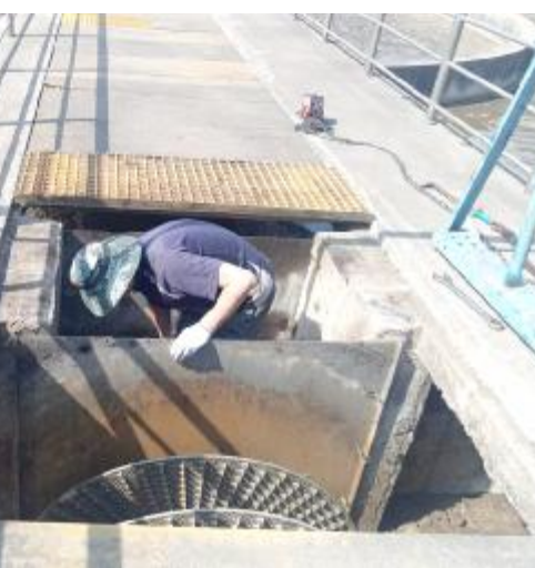
5月23日，城东污水处理厂西氧化沟转碟出现故障，为保障生产运行工作，维修班立即进行抢修。维修班技术人员顶着酷暑，克服种种困难，于当天13点完成抢修工作，恢复设备正常运行，有力地保障了城东污水处理厂设备正常运转、工艺稳定。梁杨子 户红利 摄
