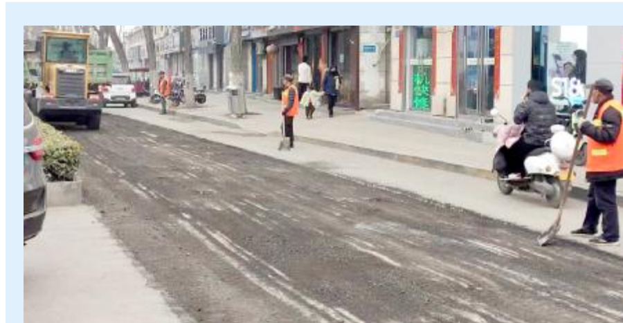
3月5日，市住建局对城区道路破路路面进行维修，重点对产成路段与双湖路交叉口、煤山公园北门公交站牌前、洗耳路交叉口、北门里路口、市标西侧南侧等部位破路路面进行切割铣刨，当天共铣刨路面1200余平方米。牛莉萍 李为体 摄
