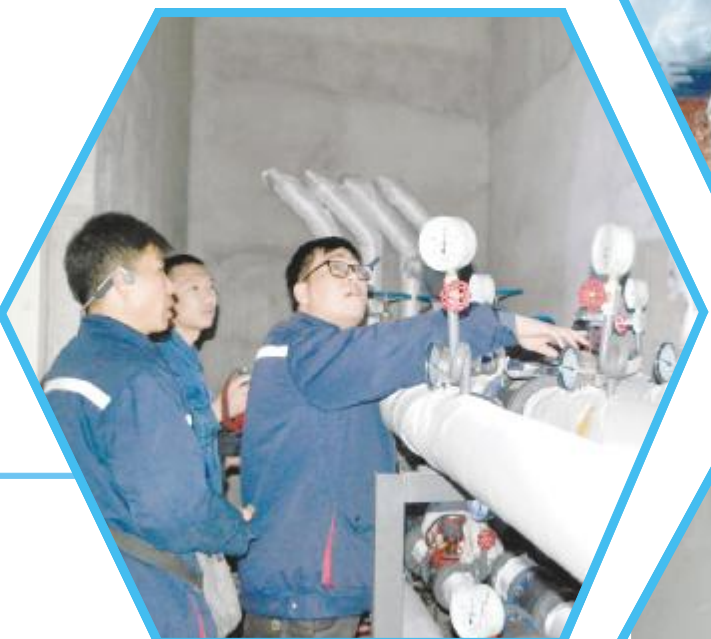
做好供暖隐患排查
