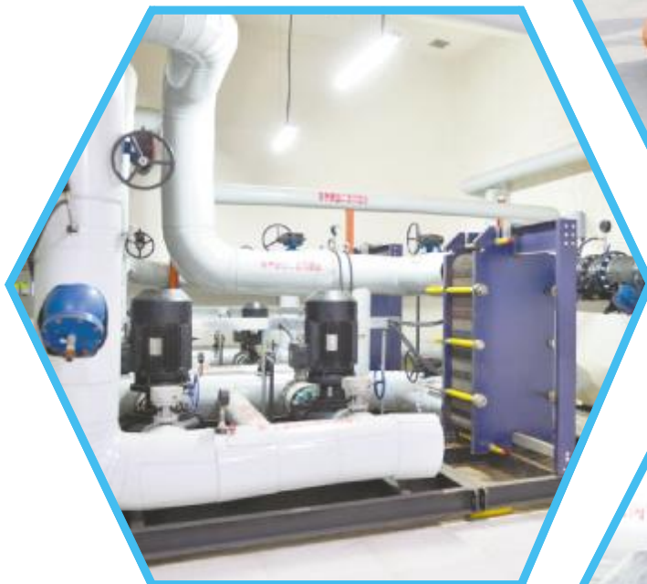
新安装的换热站供暖设备
