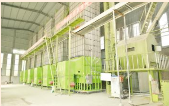
正在运行的大型烘干设备
