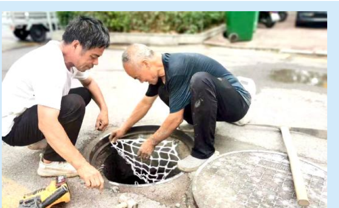
7月5日，记者在风穴路段看到，工作人员正在对一处窞井盖装配尼龙质地的专业防坠网，全力保障群众“脚下”的安全。 陈晶 摄
