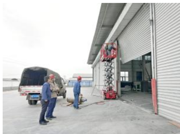
11月7日，汝州丰远实业有限公司员工正在对因大风损坏的厂房大门进行切割作业。 王德伟 摄
