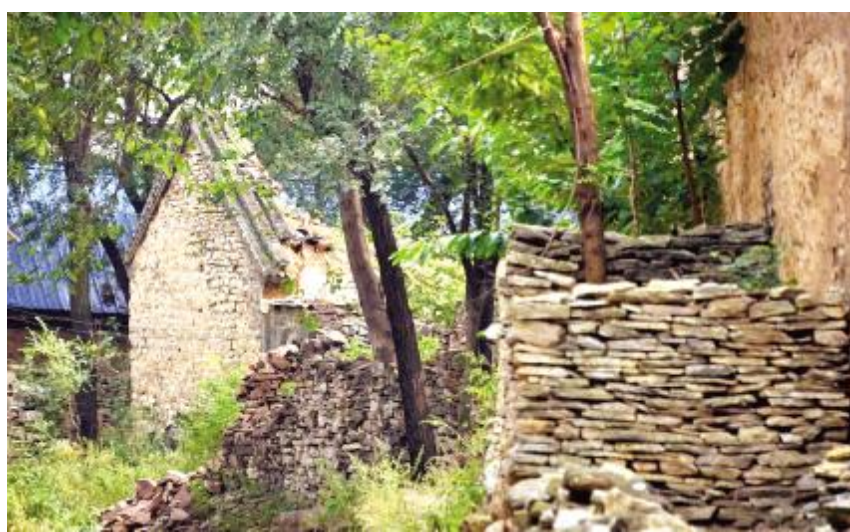
部分寨墙已坍塌
