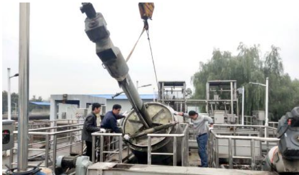
记者日前从城东污水处理厂获悉,为提高污水处理效率,节能降耗,达到经济高效运行的目标,该厂积极加强日常设备维护管理工作,定期开展设备维修保养,坚持定时巡视检查,做好记录,发现问题及时排除,使厂区设施、设备保持最佳工作状态,确保系统稳定运行。图为设备维护现场。 梁杨子 赵建强 摄
