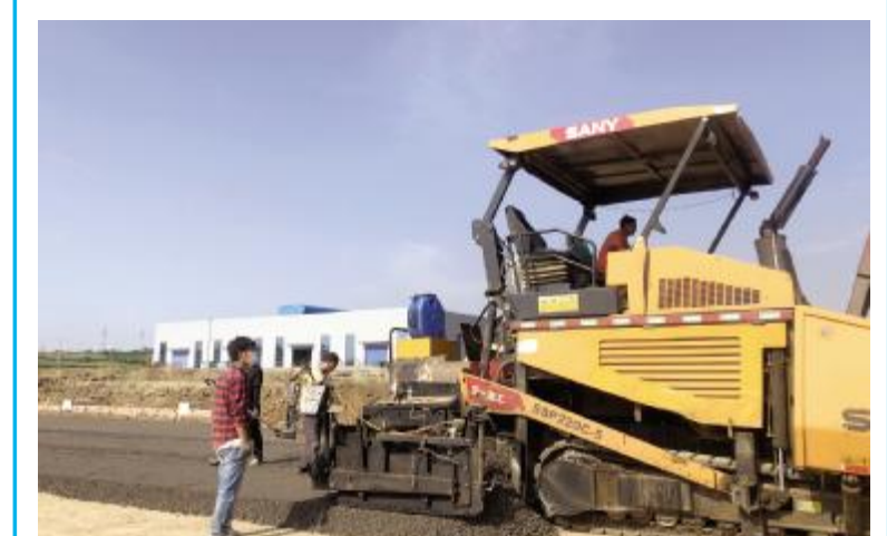
9月1日,在产业集聚区河南弘诺环保科技有限公司的厂区,工人们正在铺设厂区主路水稳层以及进行2号厂房钢构除锈和门窗房顶圆梁支模工作,加快推进厂区尽早投入使用。梁杨子 摄
