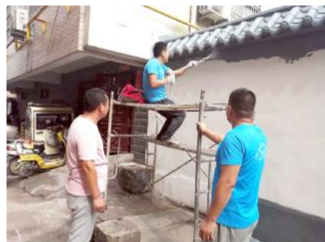
近日，市住建局施工人员对结对帮扶小区帝景苑新区的外墙改造粉刷、规整弱电。目前已全部完工，小区面貌焕然一新。 梁杨子 摄
