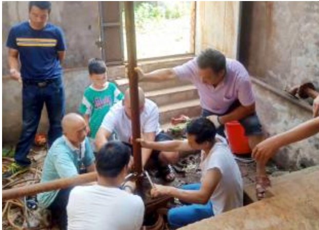
7月4日，寄料镇牛沟村的水泵突发故障，村民杨建锋、王黑子、曹帅国等自发组成维修小分队，顶着烈日，在当天下午6点将新水泵更换完成，试运行正常。
