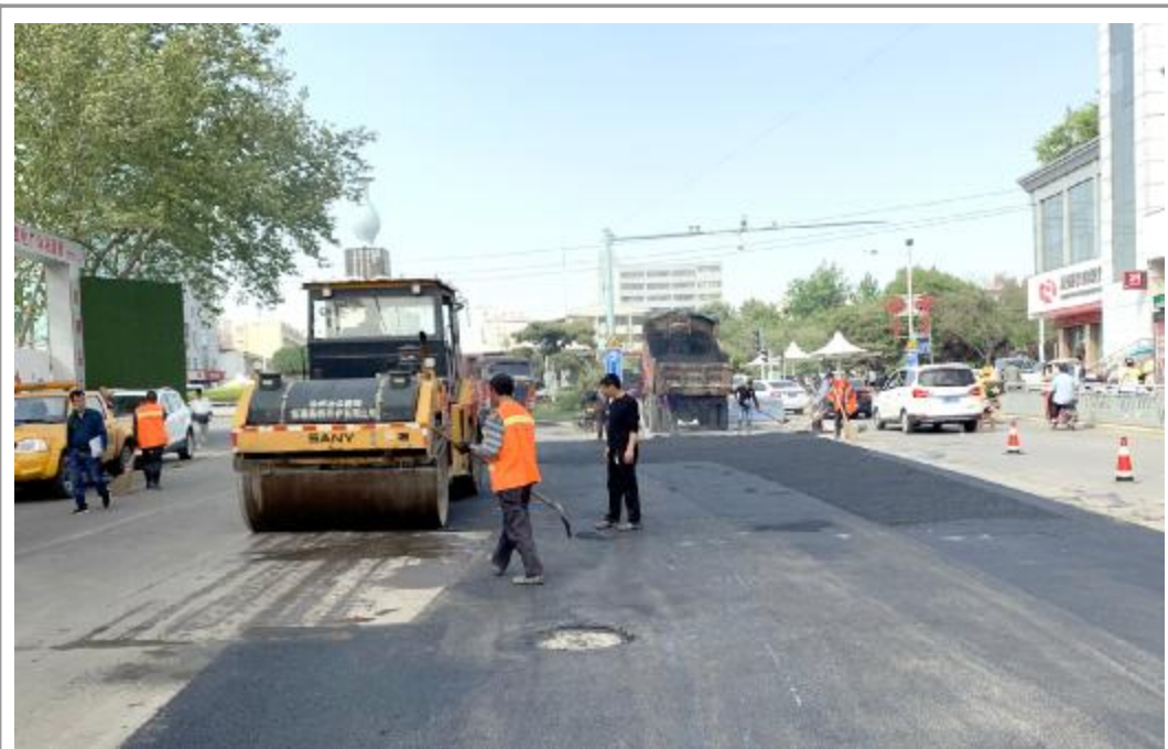
4月17日，市住建局对广育路、城垣路、西环路等道路破损路面进行沥青铺设修补。据了解，此次共铺设沥青面积约1000平方米。因为市政工人在修补市标处破损路面。梁杨子 摄
