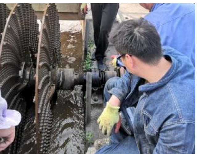
3月24日，市产业集聚区污水处理厂组织机修班、运行班职工安排大型起重设备对氧化沟转碟电机、减速机进行吊装维修，对氧化沟转碟基座进行加固，做到对损坏设备早发现，早抢修，争取第一时间恢复稳定。金晓刚 摄
