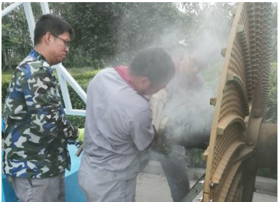
头顶烈日，双手托着加热滚烫的轴承，用最快的时间和最精准的力道一点一点对上……这是近日高温天气下，市产业集聚区污水处理厂机修班职工抢修污水处理设备的画面。市产业集聚区污水处理厂工业污水水量波动大、进水成分复杂，污水处理设备要24小时连续不间断运行。早发现、早抢修损坏设备，对生态环境保护有较大意义。 金晓刚 摄
