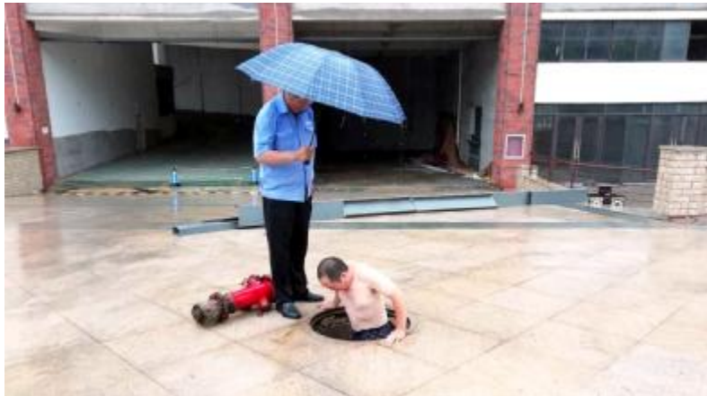
6月20日，雨还在下着，万汇城小区商铺门前的消防栓被过往的车辆撞坏破裂，现场蹿起一米多高的水柱。接到抢险命令，维修人员孙景占立即赶赴现场，雨水和消防栓的水早已把衣服打湿了，他赤膊上阵，冒雨跳入表井中。小区的工作人员赶来为他撑起雨伞，孙景占猫着腰在表井中摸索着进行维修，奋战半小时后终于把损坏的消防栓修复。 梁杨子 雷文娟 摄
