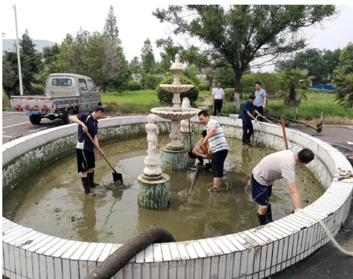
6月17日，城东污水处理厂组织职工对厂区喷泉进行彻底清理，用实际行动美化、净化厂区环境，助推创文工作。 梁杨子 卢红丽 摄
