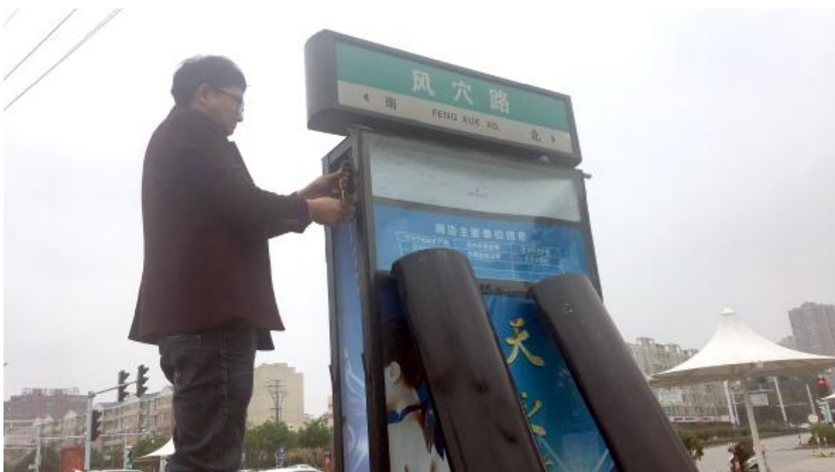
4月26日，市民政局对全市道路上出现损坏、不亮等情况的亮化道路指示牌进行检修。图为工作人员正在检修风穴路上的亮化道路指示牌。
