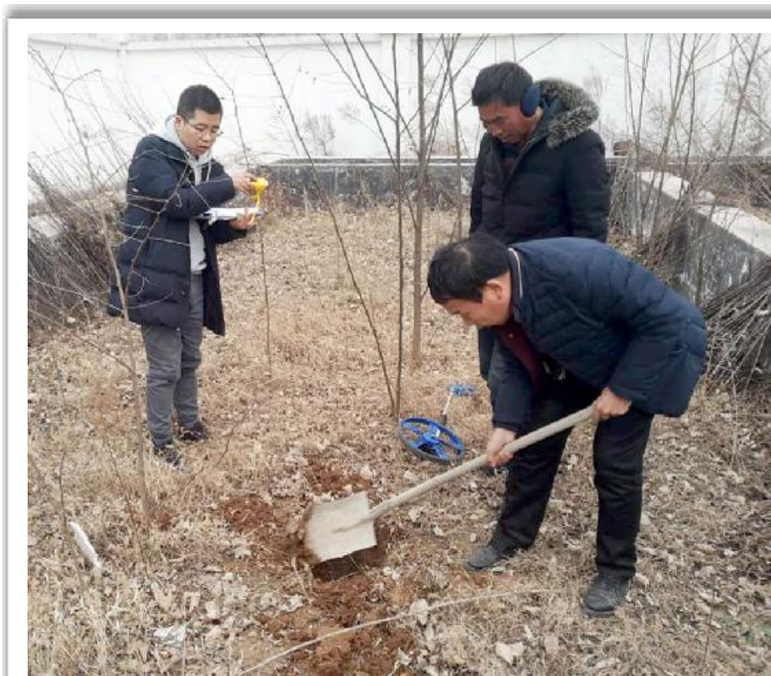
日前，市审计局投资审计中心派出审计组，对我市2017年度美丽乡村建设试点项目——蟒川镇美丽乡村建设工程进行审计。审计组重点查看了污水管网和污水处理厂、垃圾转运站、公厕、道路及照明亮化工程的建设实施情况，结合图纸和竣工资料，逐项核对技术数据，认真检验工程量是否准确、真实。图为审计人员现场勘察核实工程量。吴伟伟 摄
