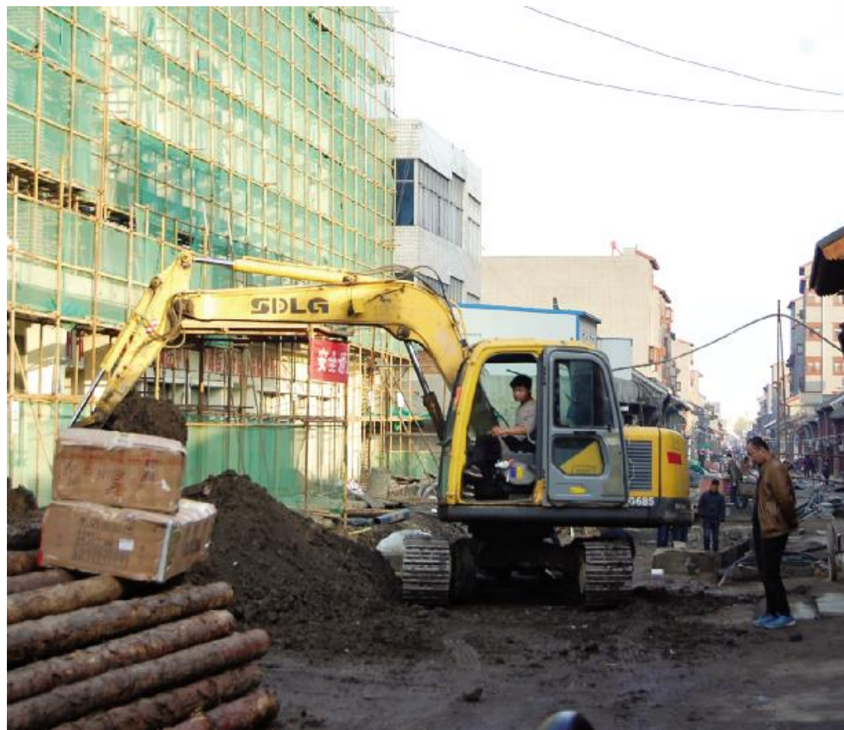
日前，记者在大街街看到，大街街历史文化街区改造已推进到老十字街，仿古建筑立面改造接近尾声，路面改造正在进行。
