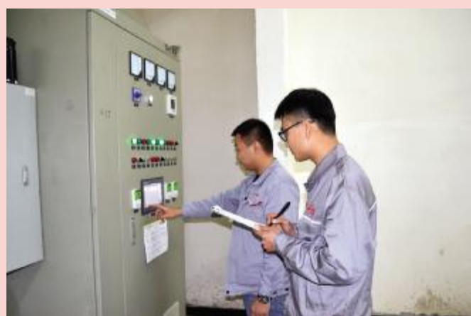
工作人员在换热站开启供热设备
