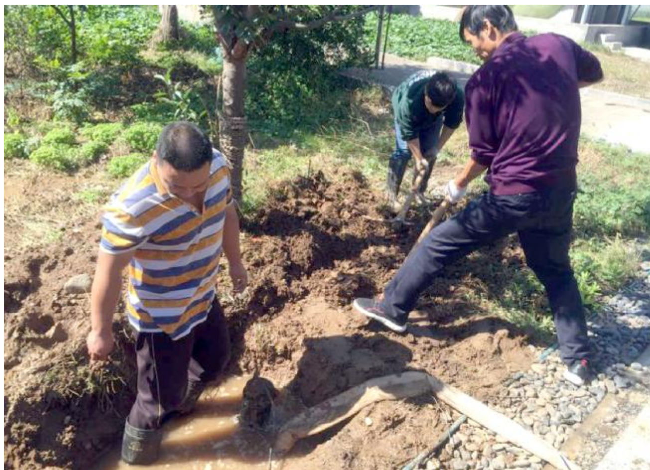
10月7日上午8点半，城东污水处理厂厂区脱泥间旁空地出现大面积积水，经初步勘察确定其下方的供水管线老化破裂。
