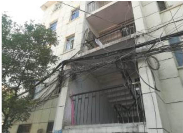
火车站南对面居民楼电线杂乱无序,存在很大安全隐患
