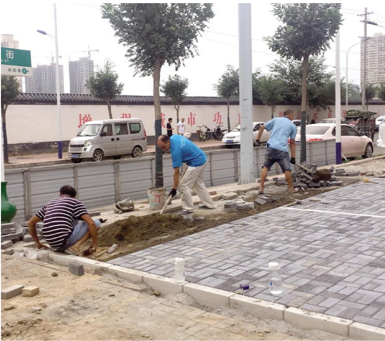
8月31日,朝阳路与永安街路口,数名施工人员在加紧进行人行道铺砖升级改造工作。宋小亚 摄
