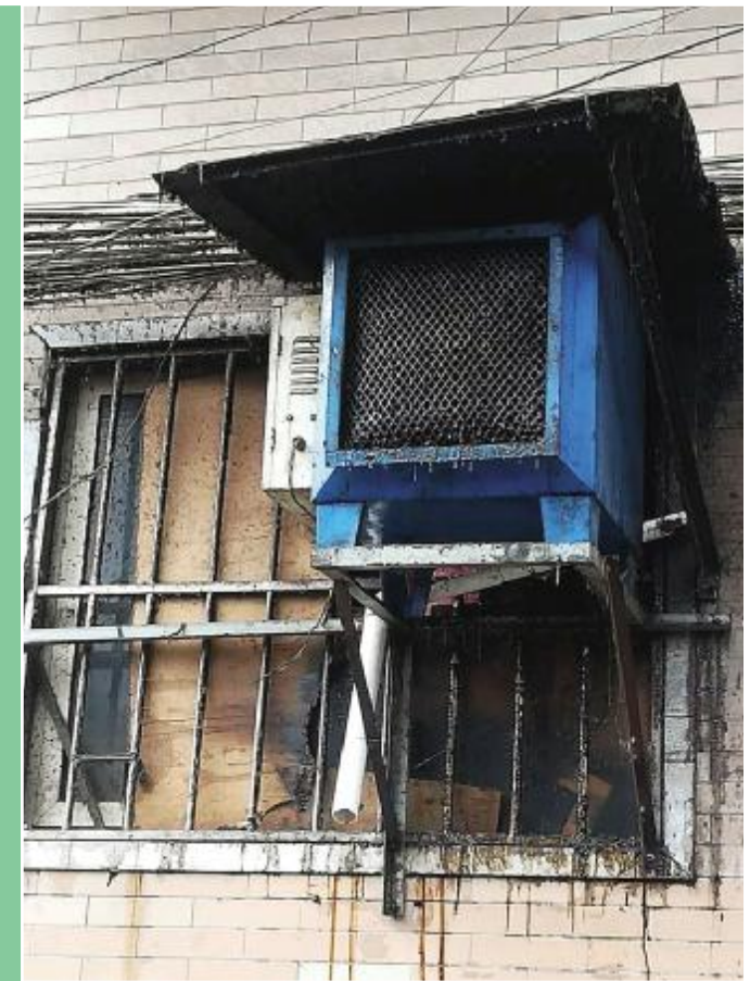
公园新居院内抽油烟机油污顺墙流,电线被熏上厚厚的油垢。
