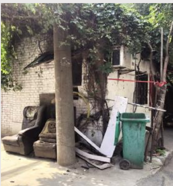
一处家属院内私自改电、摆放杂物。
