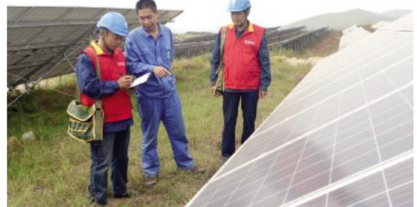
服务光伏发电项目
