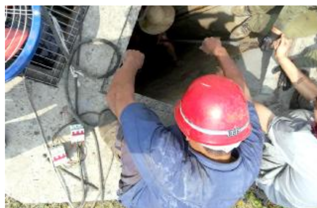
6月25日，市产业集聚区污水处理厂职工在对配套污水管网收水情况排查过程中，发现工业大道东段污水管道被生活垃圾等杂物堵塞，污水溢流。抢修人员第一时间赶到现场，依据疏通方案，从中午奋战到深夜，直至杂物清理完毕。 梁杨子 余耀祖 摄
