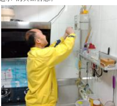
李延兴正在检查燃气设备
