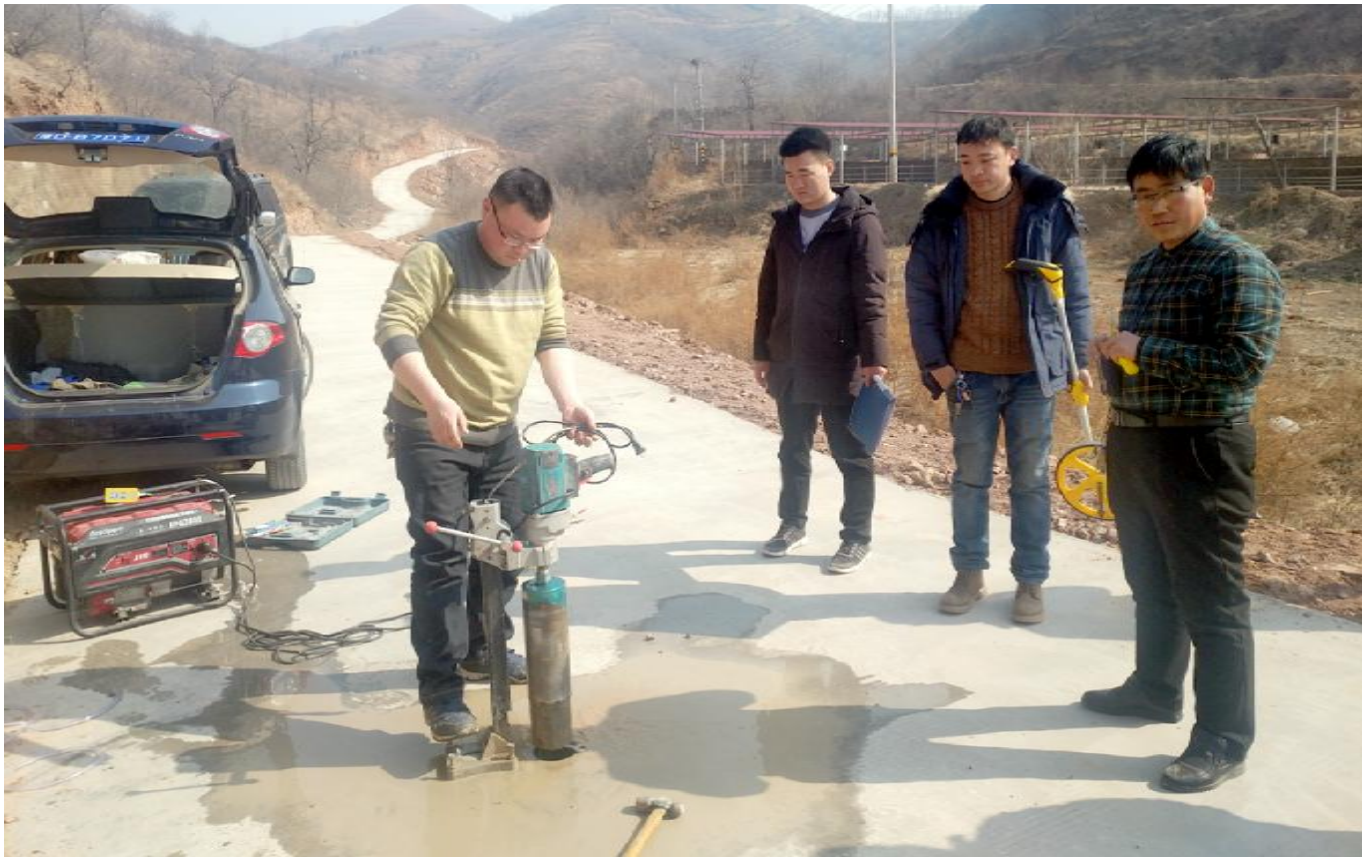
日前,市扶贫办、财政局和第三方验收组成员对米庙镇安沟村整村推进道路硬化项目进行实地勘测验收。
