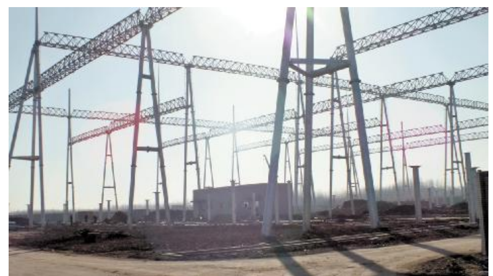
500千伏输变电站
