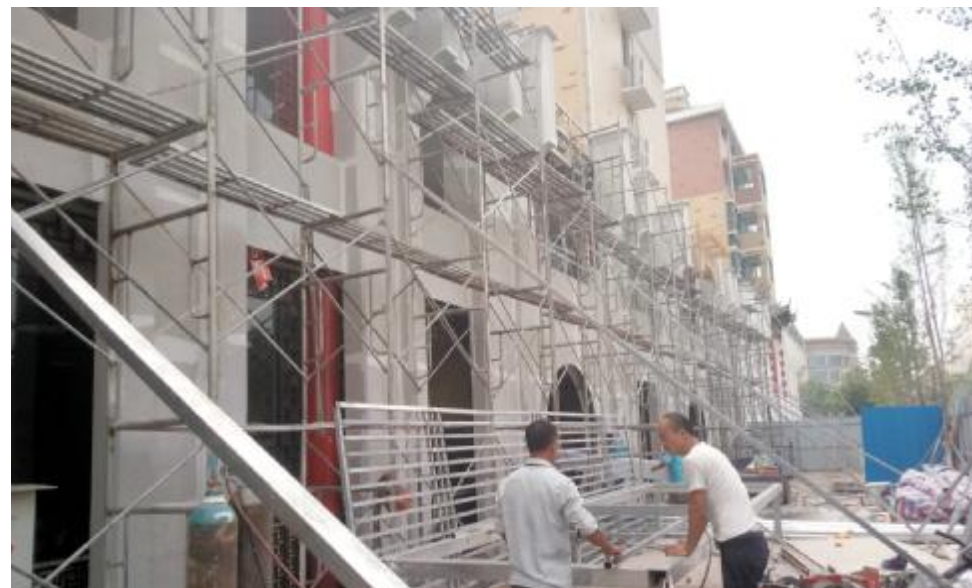
8月21日,建兴街街楼古装修按照月底完工的任务加紧施工中。 梁杨子 摄
