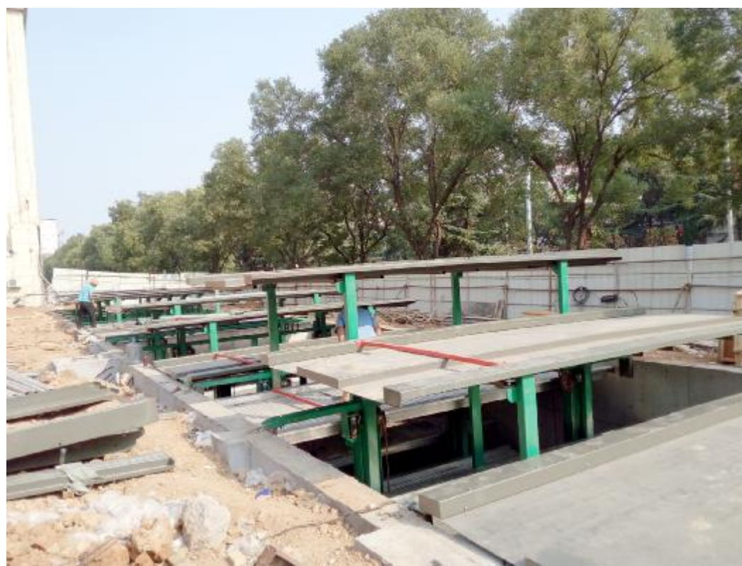
目前，广成路建行门口附近立体停车场正在调试，该停车场采用下沉式设计，静止状态时只能看到上面一排车辆，丝毫不影响路面设施观瞻。 耀辉 摄
