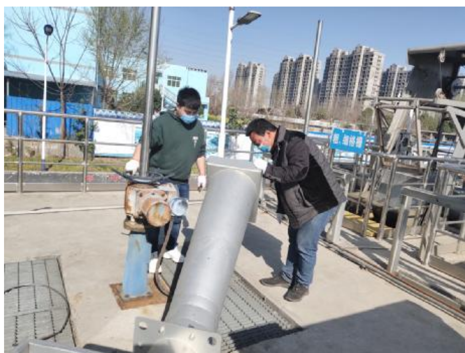
城东污水处理厂在疫情期间加强对设备设施的巡查频次，发现故障安排专人及时处理，确保设备稳定运行，污水达标排放。
